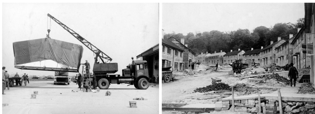
Ryc. 5. Transport i montaż prefabrykowanych budynków mieszkalnych w Wielkiej Brytanii importowanych ze Szwecji w drugiej połowie lat 40. XX stulecia. Źródło: http://fet.uwe.ace.uk/conweb/house_ages_/council_housing/section5.htm (22.03.2012)
