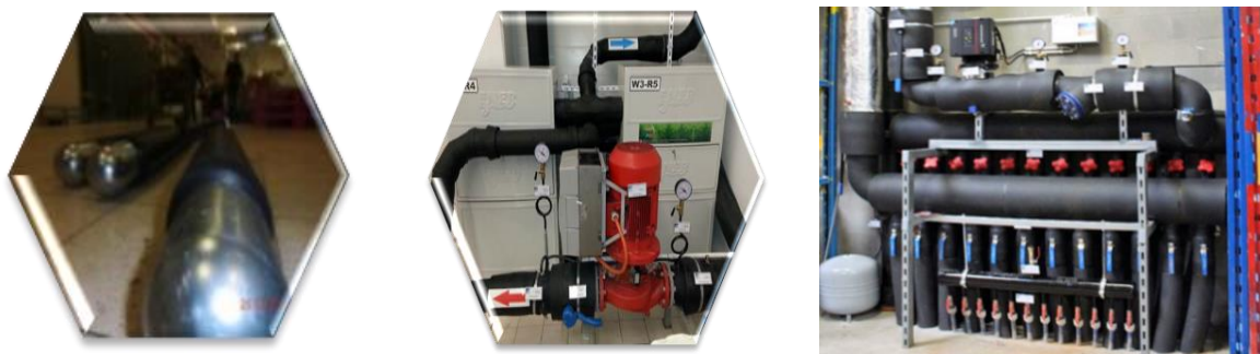
Fig. 8 View of heads, pumping stations distributors. Source: the authors. Ryc 8. Widok głowic ,pompowni i rozdzielaczy. Źródło: Materiał własny.
