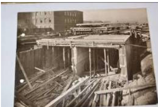
Ryc. 16. Zdjęcie prac inżynierskich przebudowy ciek wodnego w obrębie Placu Kamiliańskiego. Źródło: Dariusz Walerjański.
