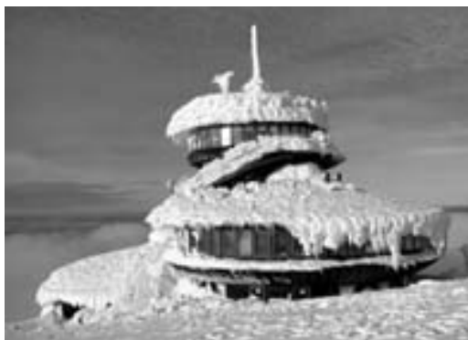
Il. 22. Karkonosze. Śnieżka. To wiatr – według hipotez – spowodował uszkodzenia w obserwatorium na Śnieżce. W budynku popękały ściany, sufit oraz podłoga. Źródło: Archiwum autora
