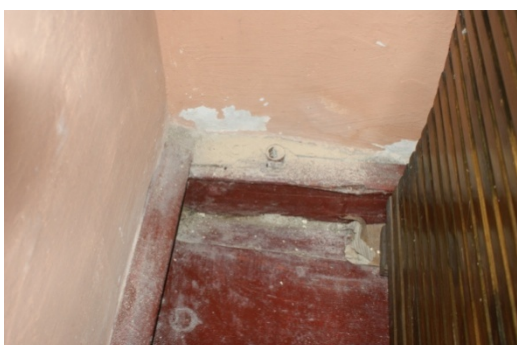
Ryc. 23. Zniszczona posadzka drewniana i uginające się deski podłogowe. Źródło: fot. H. Rutyna XI.2010
