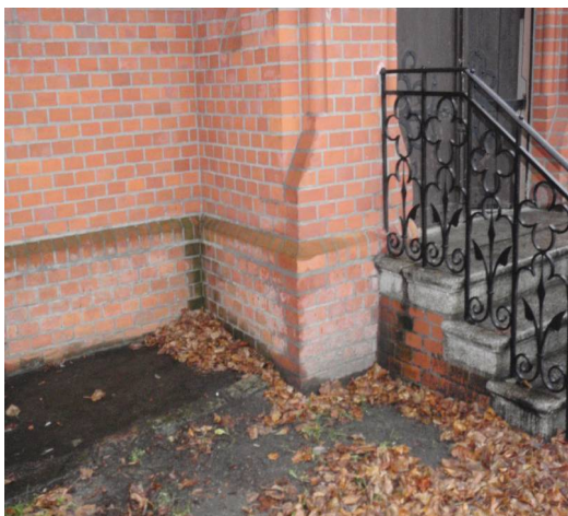
Ryc. 12. Brak połączenia do istniejącej kanalizacji deszczowej przyczynia się do rozrostu porostów są na całej powierzchni cokołu, także w części odrestaurowanej w 2009 roku. Widoczne odremontowane kamienne schody i żeliwna balustrada. Źródło: fot. H. Rutyna XI.2010
