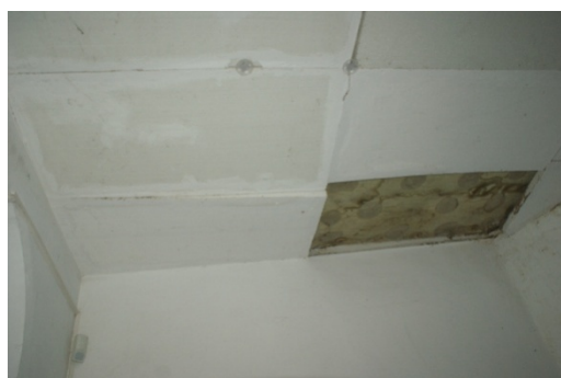
Ryc. 24. Stan techniczny sufitu zakrystii. Źródło: fot. H. Rutyna XI.2010
