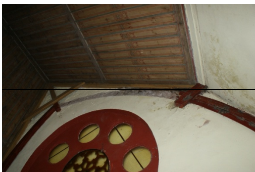
Ryc. 21. Wnętrze cerkwi – widok na ścianę północną z rozetą; zawilgocenia ścian na styku z pokryciem dachu i brak połowy łęku drewnianego po prawej stronie empyry chóru. Źródło: fot. H. Rutyna XI.2010
