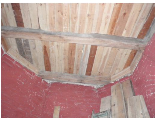
Ryc. 25. Stan techniczny sufitu magazynu. Źródło: fot. H. Rutyna XI.2010
