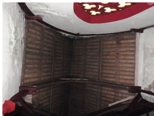
Ryc. 20. Wnętrze cerkwi – widok spodu pseudosklepienia i zawilgocenia ścian na styku z pokryciem dachu. Źródło: fot. H. Rutyna XI.2010
