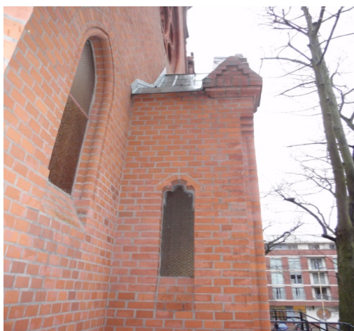
Ryc. 13. Pod oknami niektórych okien widoczne są znaczne pęknięcia cegły licowej. Źródło: fot. H. Rutyna XI.2010
