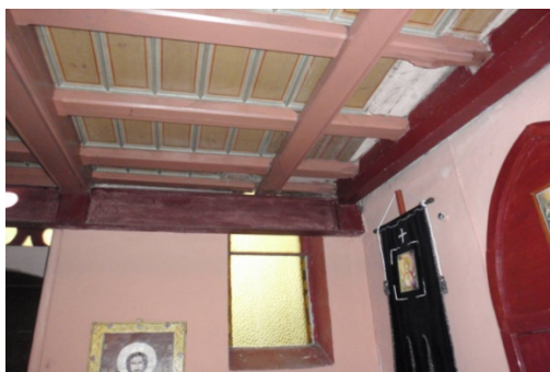
Ryc. 22. Wnętrze cerkwi – spód drewnianej empyry chórowej; nieprofesjonalnie wstawiona belka stalowa przerywająca drewniane belki. Źródło: fot. H. Rutyna XI.2010
