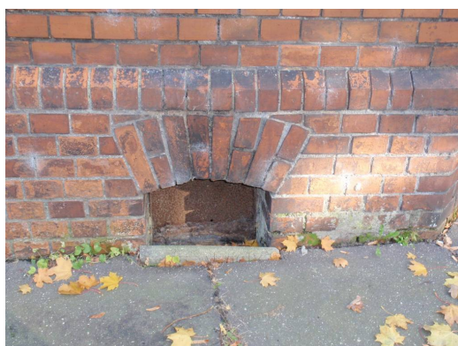
Ryc. 10. Brak stolarki okiennej w oknie piwnicznym od strony południowej cerkwi. Źródło: fot. H. Rutyna XI.2010
