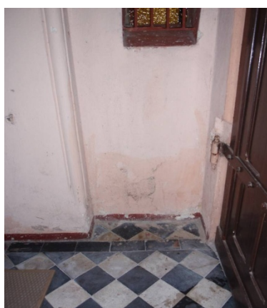
Ryc. 15. Brak pionowej izolacji ścian stanowi przyczynę problemów ciepłno-wilgotnościowych ścian budowli. Źródło: fot. H. Rutyna XI.2010
