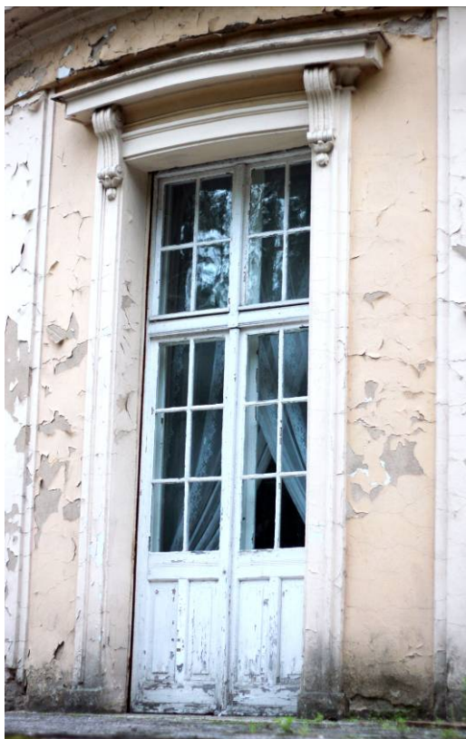
Ryc. 19. Pałac w Bieganowie, elewacja ogrodowa, zły stan stolarki drzwiowej, 2013. Źródło: il. J. J. Białkiewicz Fig. 19. Palace in Bieganowo, garden façade, poor condition of door frames, 2013. Source: photography of J. J. Białkiewicz
