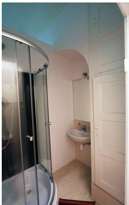
Ryc. 15. Pałac w Bieganowie, łazienka na parterze, zamalowany fresk, dobudowana ścianka działowa, stan obecny. Źródło: il. J. J. Białkiewicz
