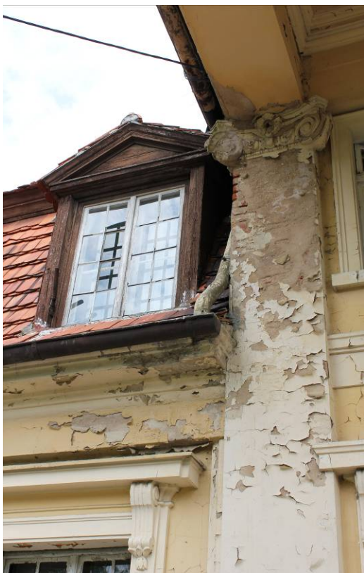
Ryc. 18. Pałac w Bieganowie, elewacja frontowa, zawilgocone ściany, 2013. Źródło: il. J. J. Białkiewicz Fig. 18. Palace in Bieganowo, front façade, dank walls, 2013. Source: photography of J. J. Białkiewicz
