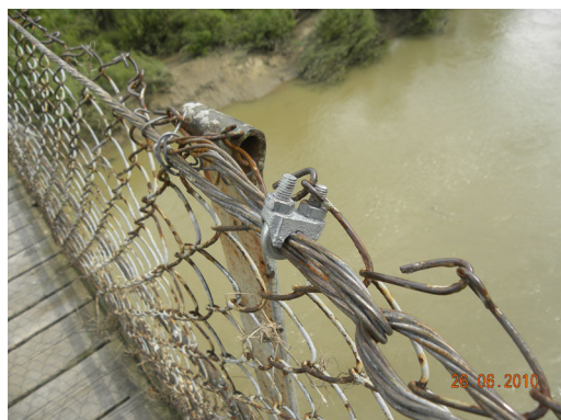
Ryc.7. Niebezpieczne dla użytkowników zakończenie poręczy, korozja. Źródło: fot. autora.
