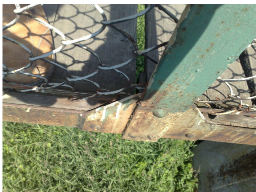
Ryc.9. Korozja podłużnic - elementów pomostu. Źródło: fot. autora. Fig.9. Corrosion of stringers. Source: photo by author
