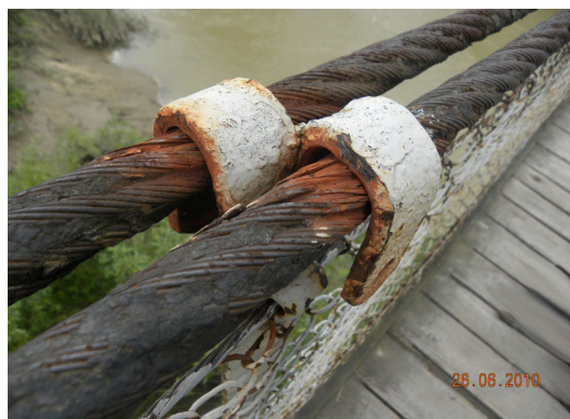
Ryc. 6. Korozja lin, przetarcia wynikające z przemieszczeń. Źródło: fot. autora.
