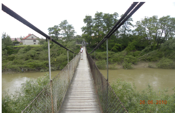
Ryc. 5. Pierwotna konstrukcja kładki. Źródło: fot. autora.
