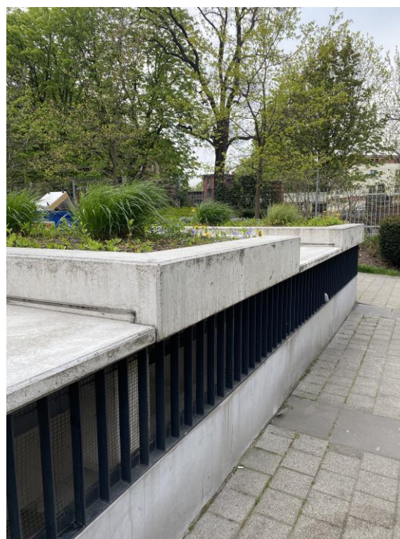
Fig. 11. Photo of greenery planted on the canopy of a ventilation system of an underground car park in Wrocław. Source: original work Ryc. 11 Zdjęcie nasadzenia zieleni na dachu od wentylacji garażu podziemnego we Wrocławiu. Źródło: autor
