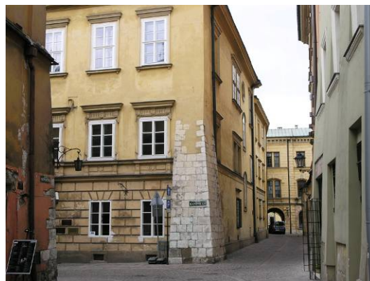
Ryc. 16. Narożnik ulic Kanoniczej i Senackiej. Z wszystkich trzech stron widoczne „oskarpowania” – pochyłe ściany i filary przyporowe – skarpy. Pośrodku budynek Instytutu Historii Architektury i Konserwacji Zabytków WAPK. Fot. Wojciech Kosiński
