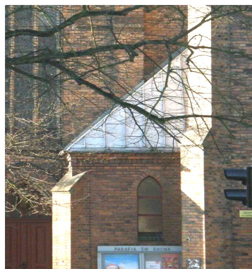
Fot. 4. Dach nad klatką schodową przyległą do wieży – w części południowej. Źródło: fot. H. Rutyna, XII.2008
