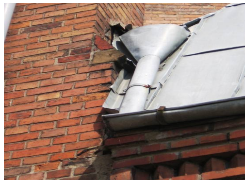
Ryc. 9. Pokrycie dachu kaplicy południowej – uszkodzona obróbka połączenia pokrycia dachu ze ścianą. Źródło: fot. H. Rutyna, XII.2008 Fig. 9. Roofing south chapel - damaged roof covering working combination with the wall. Source: photo H. Rutyna, XII.2008
