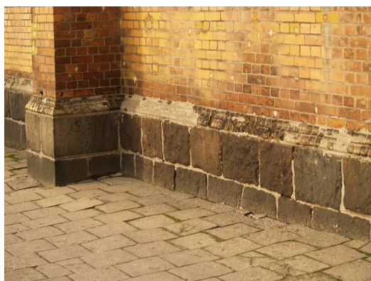
Ryc. 1. Ubytki kształtek ceramicznych i efekt uboczny niewłaściwie prowadzonych napraw na linii cokół – ściana. Źródło: fot. H. Rutyna, XII.2008
