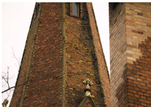
Ryc. 11. Widoczne uszkodzenia w ciągu cegieł oraz ubytki w spoinach w północno - zachodniej części wieży. Źródło: fot. H. Rutyna, XII.2008
