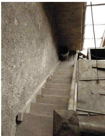
Ryc. 21 b. Wnętrze wieży. Drewniane schody prowadzące na poziom ~+17,00 m. Źródło: fot. H. Rutyna, XII.2008
