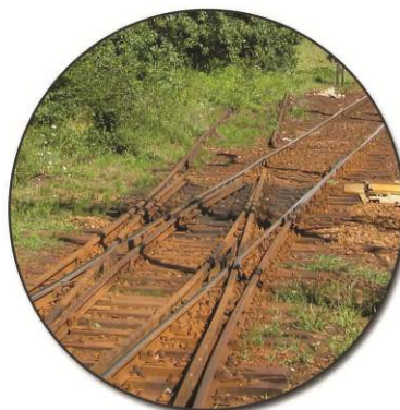
Ryc. 2. Rdzewiejące szyny kolejowe. Źródło: il. K. Gardjew
