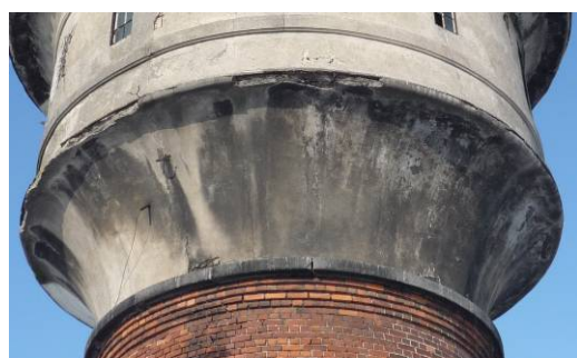
Ryc. 4. Gzyms wieńczący trzon głowicy wieży ciśnień przy dworcu kolejowym w Żninie. Źródło: il. autora
