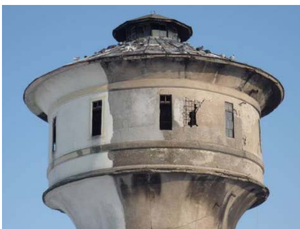
Ryc. 8. Widoczne zniszczenia głowicy wieży w Żninie. Źródło: il. autora
