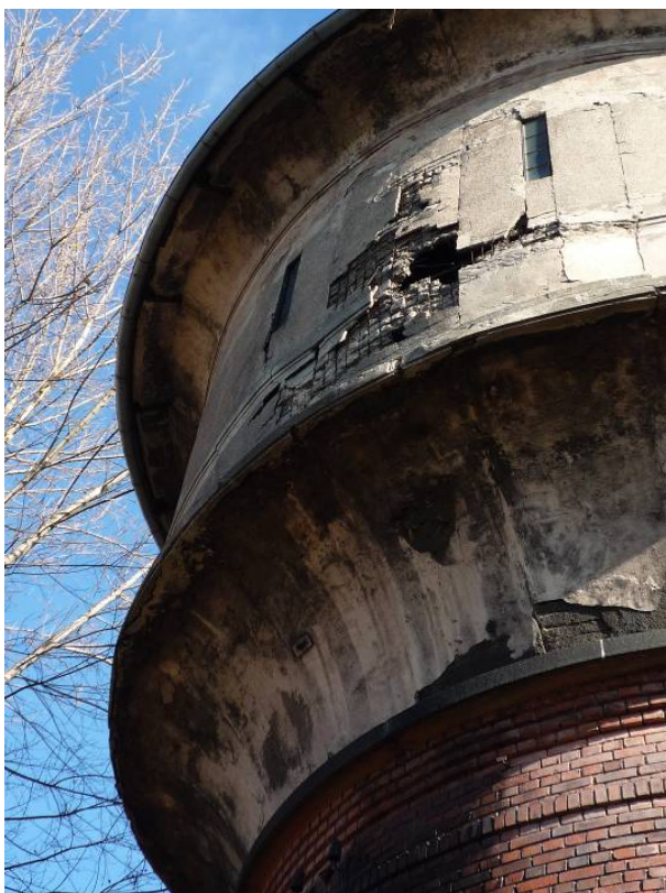
Ryc. 9. Uszkodzenie głowicy wieży ciśnien w Inowrocławiu. Źródło: il. autora
