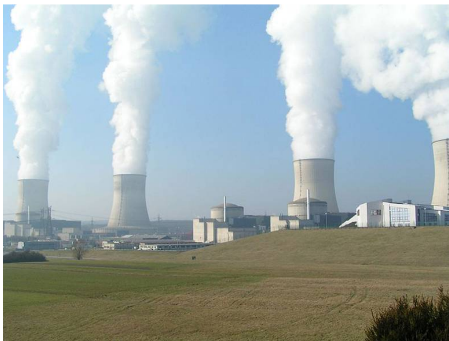
Il. 4. Elektrownia jądrowa w Cattenom – największa elektrownia francuska z czterema reaktorami o mocy po 1300 MW/rok każdy. Źródło: www.wikipedia , autor Stefan Kühn
