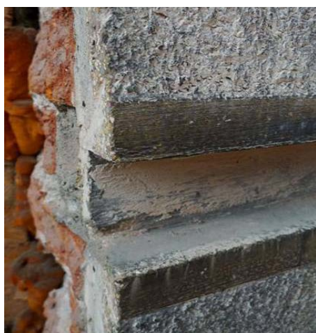
Il. 6. Kraków, ul. Warszawska – oryginalny tynk szlachetny wykonany z dwóch warstw zaprawy, wykończony poprzez gradzinowanie i polerowanie powierzchni. Źródło: fot. autora
