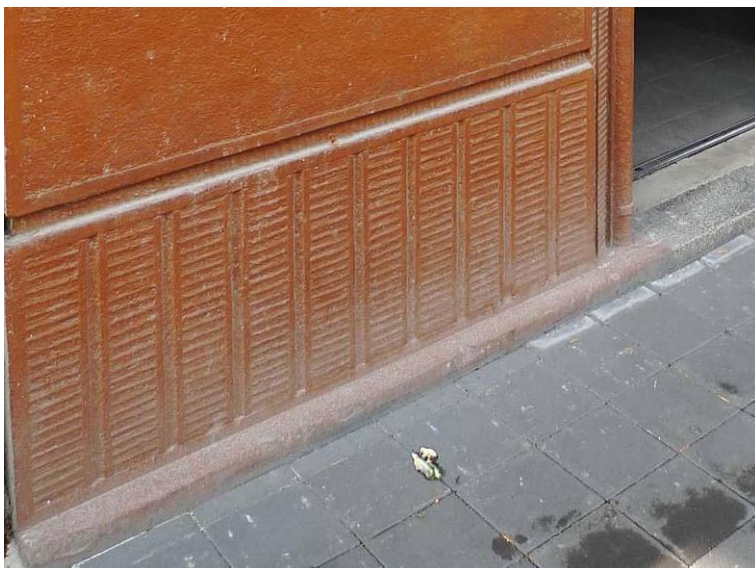
Il. 9. Kraków, ul. Warszawska – powierzchnia tynku szlachtetnego pomalowana farbą emulsiyjną lub, co gorsza olejną – zamiast zwykłego umycia... Źródło: fot. autora
